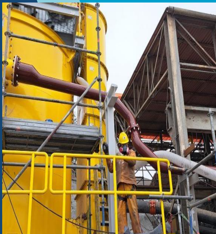
PIPING DE CELDAS DE FLOTACIÓN
