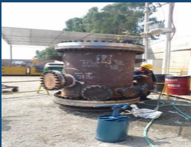
PRUEBA DE TANQUE DISTRIBUIDOR
